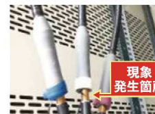
現象発生状態
