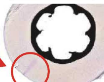
高圧ケーブル断面
