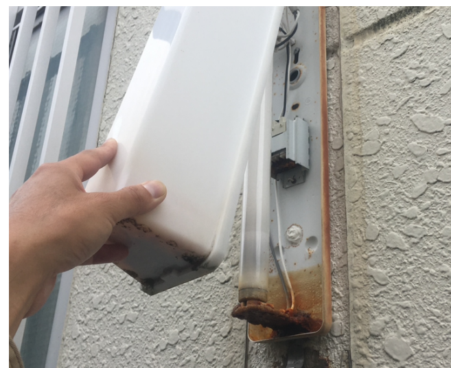
水の浸入により内部が腐食した屋外灯
