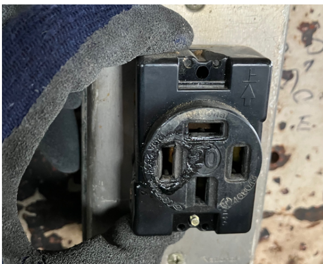
過電流により溶けたコンセント
