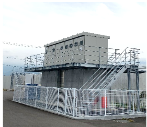
キュービクルもかさ上げした。
