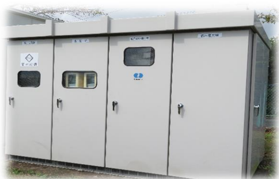
キュービクル式受変電設備
