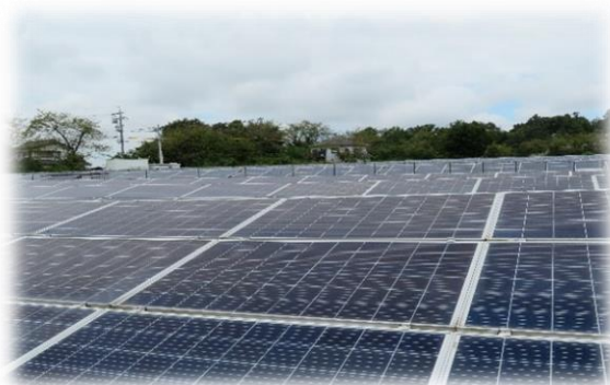
太陽光発電所
