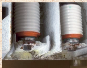
真空遮断器 絶縁不良
