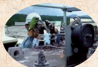
変圧器焼損 (継電器電源喪失)
