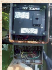
地絡継電器 経年劣化動作不良
