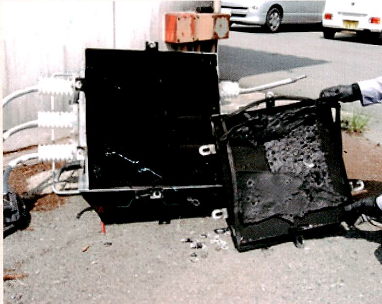
▲SOG内部がすすで真っ黒になっている。一次側にて相間短絡を起こしている。
