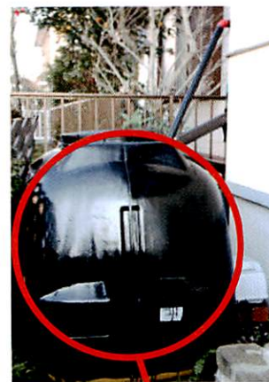
メインタンク (藻の発生を防ぐ為に黒く塗ってあります。)
