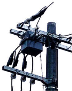
避雷器(LA)・制御電源(VT)内蔵 区分閉器(SOG)の例
